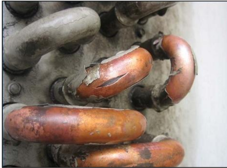
Şekil 12. Donma sonucu kuru soğutucu borularında meydana gelen tipik bir hasar [11]
