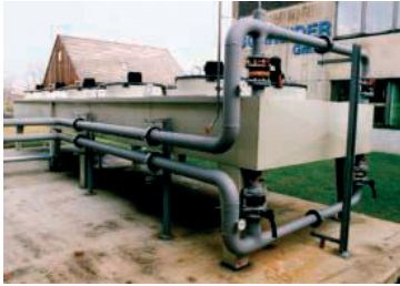
Şekil 36. Sistemde kurulu kuru soğutucu [45]
